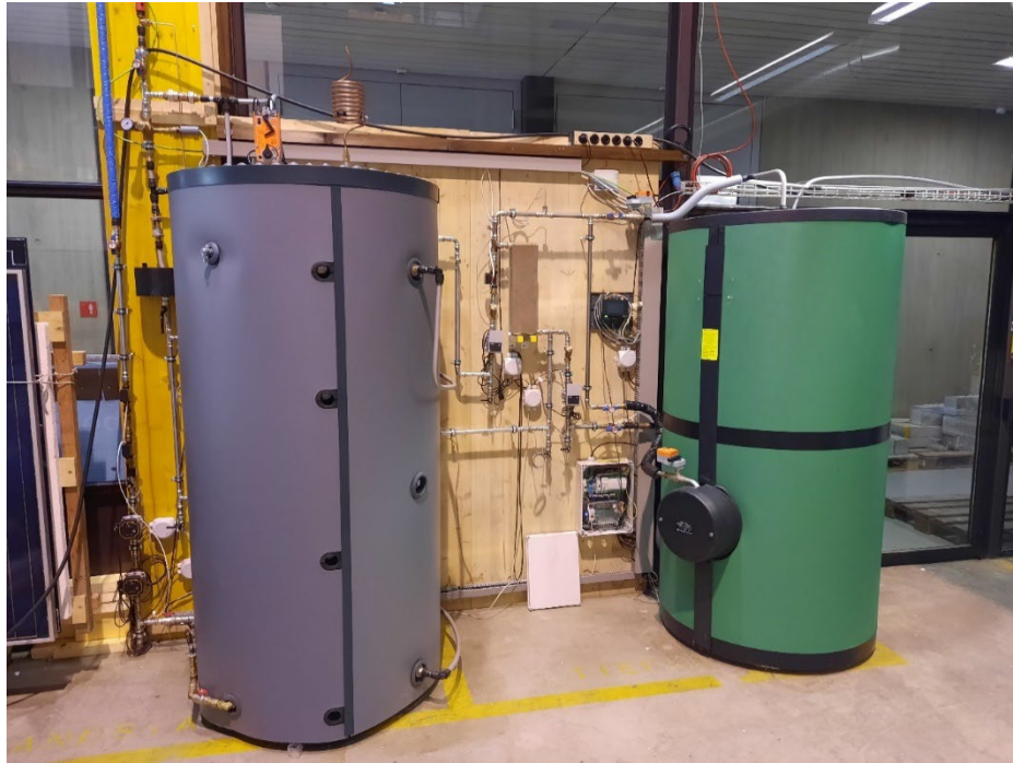
Abbildung 9: Laboranlage mit Solarspeicher (grau) und Boiler (grün). Zwischen den Speichern ist die Umladestation und die Anlagensteuerung montiert, links vom Solarspeicher die Verrohrung des Solarkreises.
