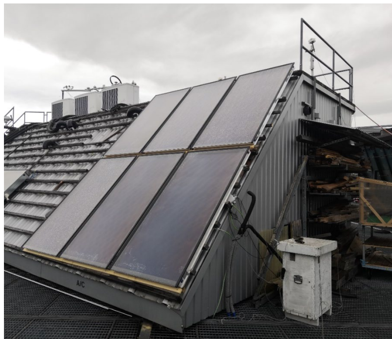
Abbildung 10: Kollektorfeld mit zwei parallel verschalteten und übereinander montierten Reihen à drei Kollektoren.
