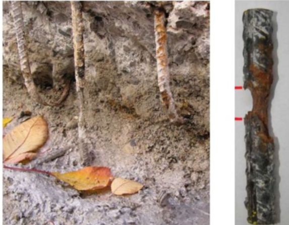
Abbildung 3. Detailansicht eines korrodierten Stahlstabs. Aus Gefährdungsanalyse bestehender Stützmauern, S. 174. Copyright 2021 bei Bundesamt für Strassen.
