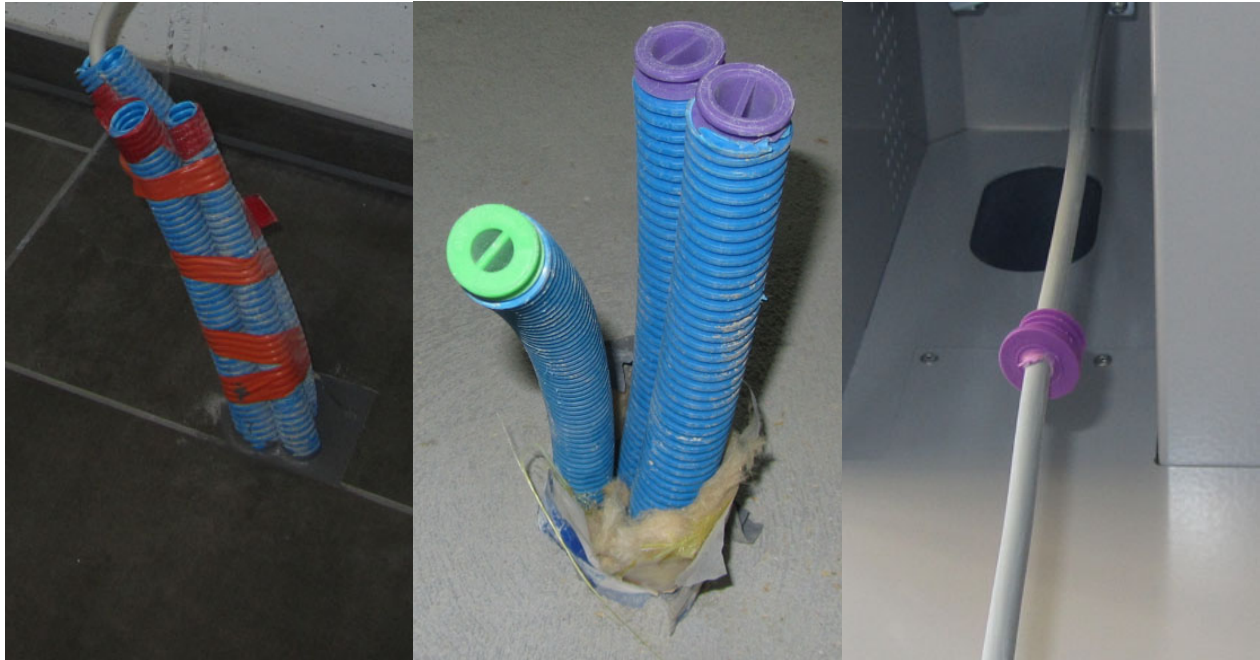
Bild 7 Beispiele für eine gute Abdichtung von Durchbrüchen für Leerrohre und die Verwendung von Dichtstopfen für un-/benutzte Leerrohre. Das rechte Bild zeigt die Situation für ein noch nicht montierten Storenmotor. Der Dichtstopfen, um im Endzustand das Leerrohr abzudichten ist schon vorhanden.
