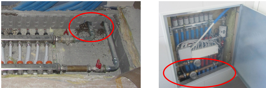
Bild 4 Typische Leckagen der Heizungsverteilung (Fussbodenheizung) als Folge unvollständiger Abdichtung im oder zum Installationsschacht.
