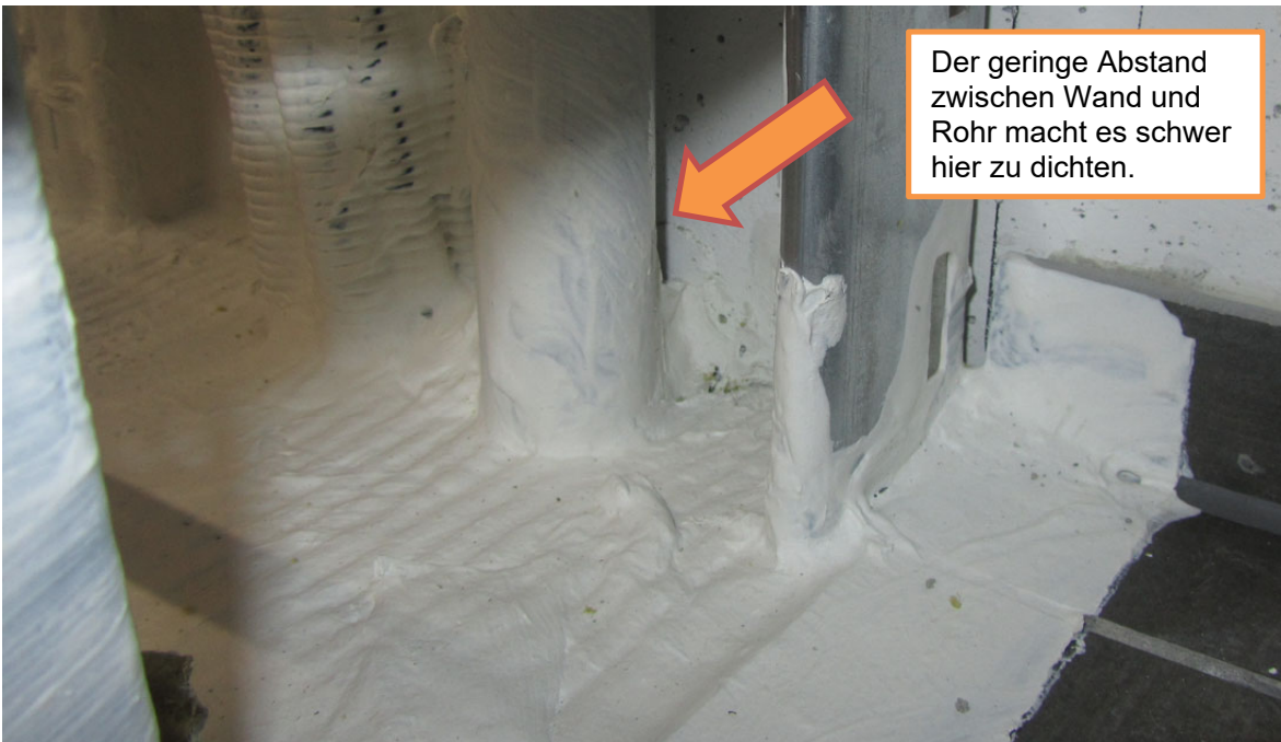
Bild 6 Brandschutzabschottung in Geschosdecke für Elektrokabel mit/ohne Leerrohr und weiteren Rohren. Um die Elektrokabel ist es luftdicht abgedichtet, aber zwischen Rohr und Wand gibt es eine Lücke in der Brandschutzabschottung. Wenn der Wandabstand nicht gross genug ist, ist es sehr schwer zwischen Kabel/Rohre und Wand die Brandabschottung luftdicht einzubringen.
