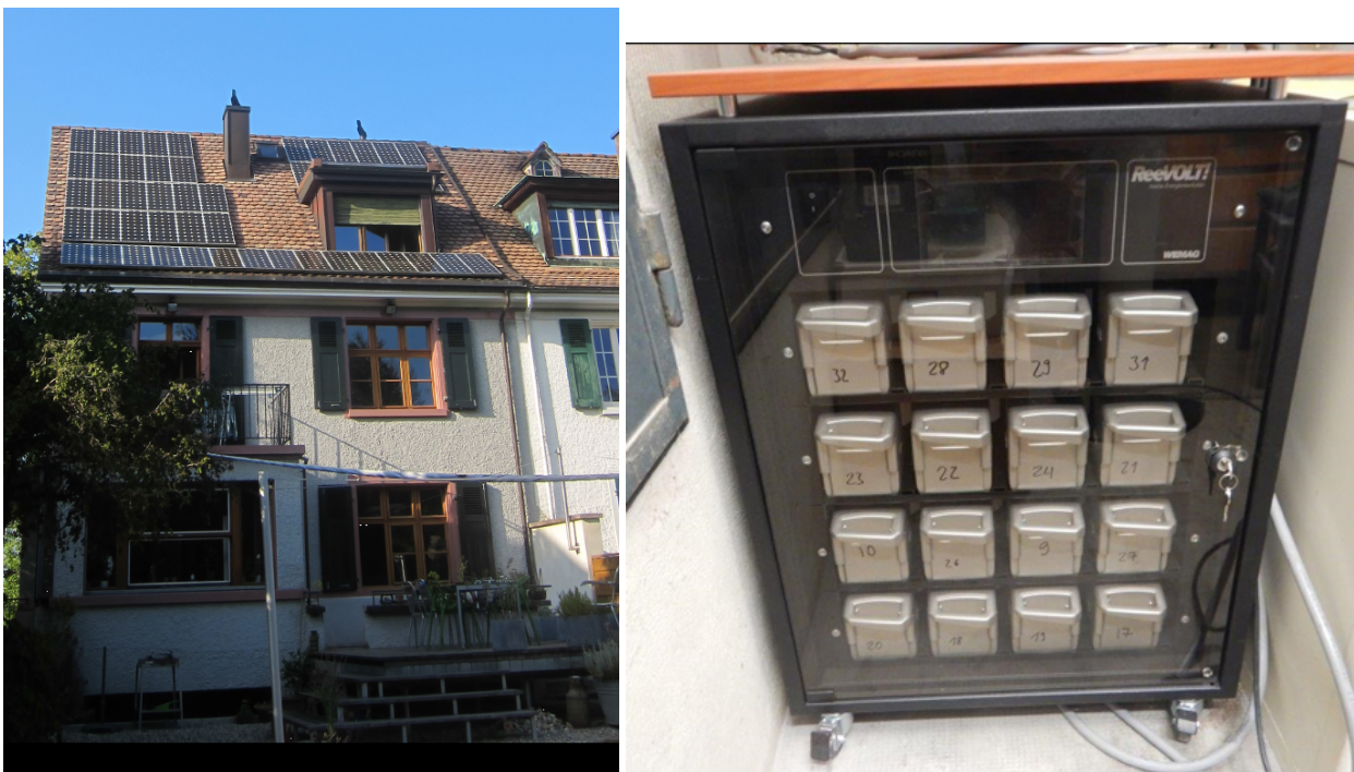
Abbildung 27 Aussenansicht EFH Nemeth, eingebauter ReeVolt-Speicher.
