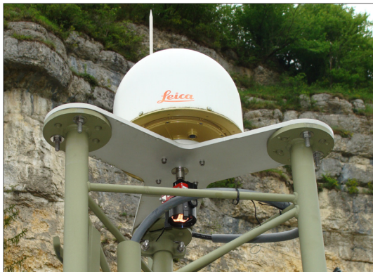
Abb. 4: Für die Integration der GNSS-Permanenstation MTTI in das geodätische Netz wurde ein spezieller Adapter konstruiert. Damit kann das Phasenzentrum von GNSS-Antennen direkt zentrisch über einen Steckzapfenbolzen („SBB-Bolzen“), auf welchen eine Zielscheibe oder ein Prisma invers aufgesetzt werden kann, eingemessen werden.
