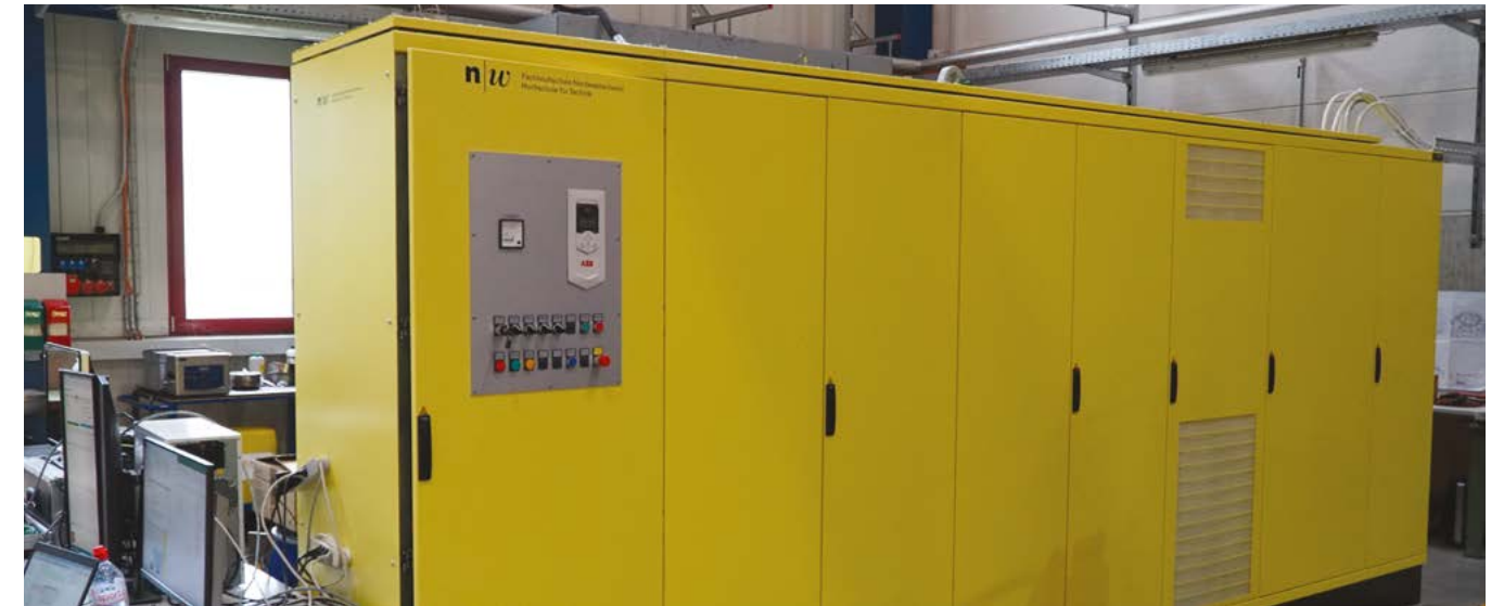
Abbildung 2: Die Einspeisung, Zwischenkreisnetzgerät, 12 Umrichter der Motoren sowie Komponenten der Steuerungs- und Regelungstechnik wurden in einem rund 8m langen Schaltschrank eingebaut.
